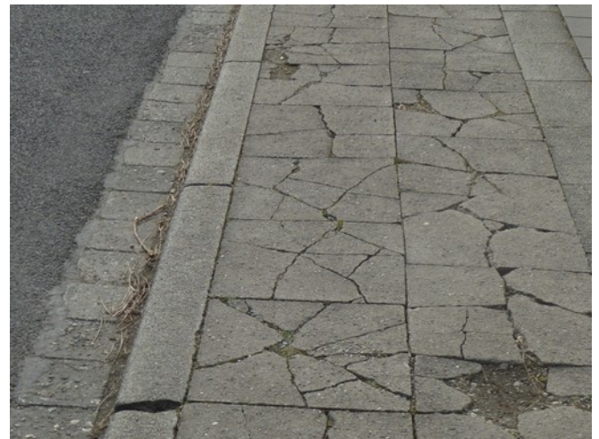
Bild 11: Typische Gehwegschäden durch zu schwere Fahrzeuge
